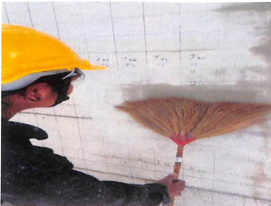
ภาพแสดงการปิดผนังด้วยไม้กวาดอ่อน เพื่อให้เม็ดทรายที่เกิดจากการปั่นลงฟองน้ำออกจากพื้นที่ เสร็จกระบวนการซ่อมแซมรอยแตกร้าว
