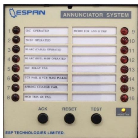
แผนภาพที่ 5 อุปกรณ์แจ้งเหตุที่ติดตั้งบนหน้าตู้สวิตช์เกียร์
