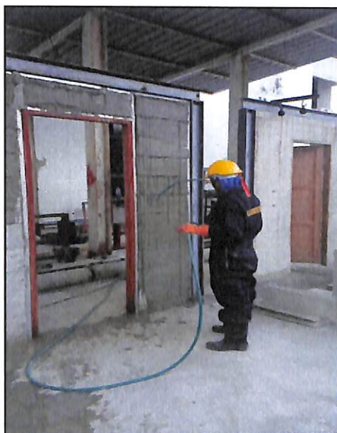
ภาพประกอบที่ 3.9 ขั้นตอนที่ 1 การรดน้ำบนผนังเพื่อทำความสะอาดฝุ่น เศษปูน ที่เกาะบนผิวผนัง และป้องกันไม่ให้ผนังดูดน้ำจากปูนฉาบ
