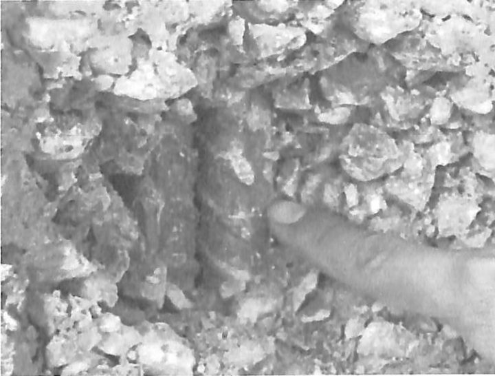
ภาพที่ 2.5 แสดงคอนกรีตที่ไม่ได้คุณภาพคอนกรีตเป็นโพรง
