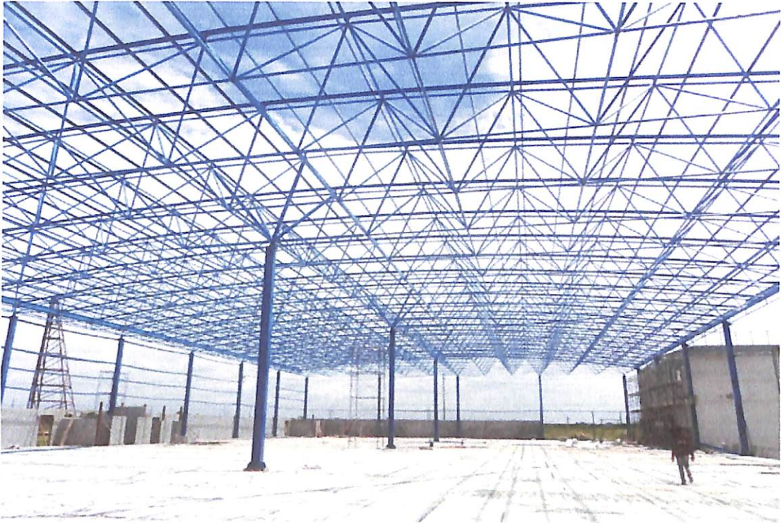
ภาพประกอบที่ 2.12 รูปแบบโครงสร้างหลังคาเป็นแบบโครงข้อแข็งสามมิติ (Space Rigid Frame)
