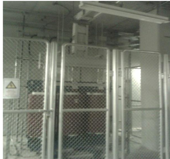
หม้อแปลง 24/0.4kV
