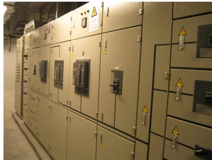
แผงจ่ายไฟฟ้าแรงต่ำ
