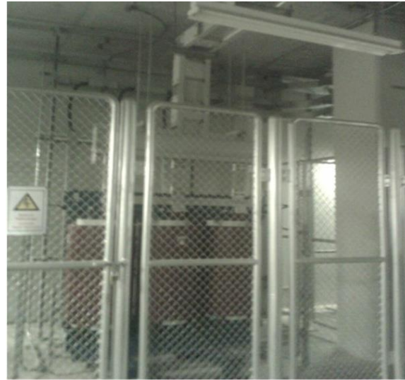
หม้อแปลง 24/0.4kV
