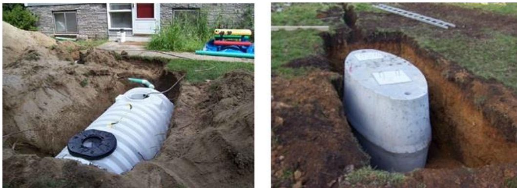
รูปภาพ 88 แสดงถังเติมอากาศใต้ดิน
