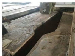
7. รางล้างแ่ทางลาดน้ำไหลผ่าน
