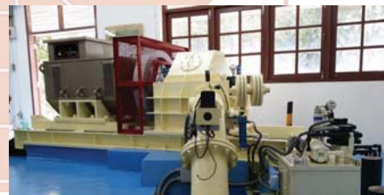
รูปที่ 1 เครื่องกังหันพลังงานน้ำชนิดเทอร์โก ของโรงไฟฟ้าพลังน้ำขนาดเล็กมากบ้านขุนแปะหลังปรับปรุง
