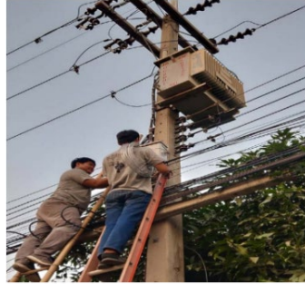
ภาพที่ 17 การติดตั้งกับระบบจำหน่ายแรงต่ำของ กฟภ.
