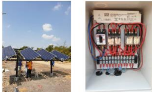
ระบบสูบน้ำบาดาล สำหรับแปลงผัก อ.บ้านฉาง จ.ระยอง
