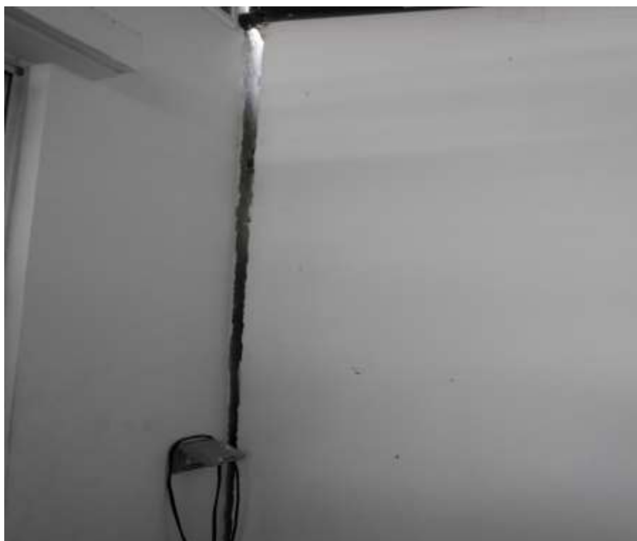
ภาพประกอบที่ 2.2 โครงสร้างบ้านทรุดตัวทำให้เกิดรอยแตกแยกบริเวณผนังบ้าน
