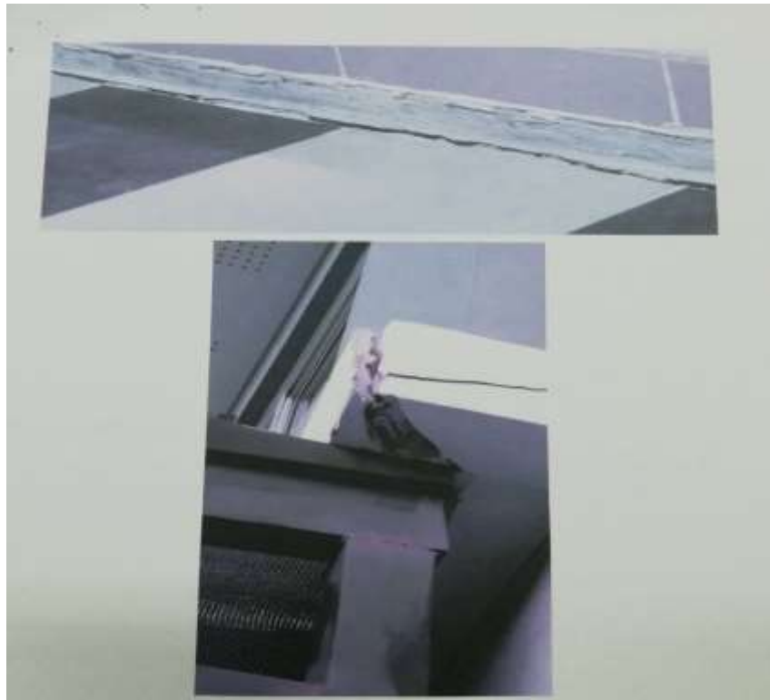
ภาพประกอบที่ 2.5 โครงสร้างบ้านทรุดตัวทำให้เกิดรอยแตกแยกบริเวณ เสา คาน หลังคาบ้านแตกร้าว
