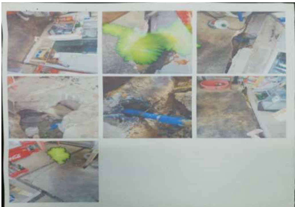
ภาพประกอบที่ 2.7 ความชำรุดบกพร่องจากการก่อสร้างโครงการบ้านจัดสรรแห่งหนึ่ง ในพื้นที่ตำบล พันท้ายนรสิงห์ อำเภอเมือง จังหวัดสมุทรสาคร ถนนหน้าบ้านทรุดทำให้ท่อ น้ำประปาในบ้านแตก ประกอบกับทางโครงการโฆษณาว่ามีที่จอดรถบริเวณ ริ้วหน้าบ้านเมื่อขับรถไปจอดทำให้พื้นที่หน้าบ้านทรุด
