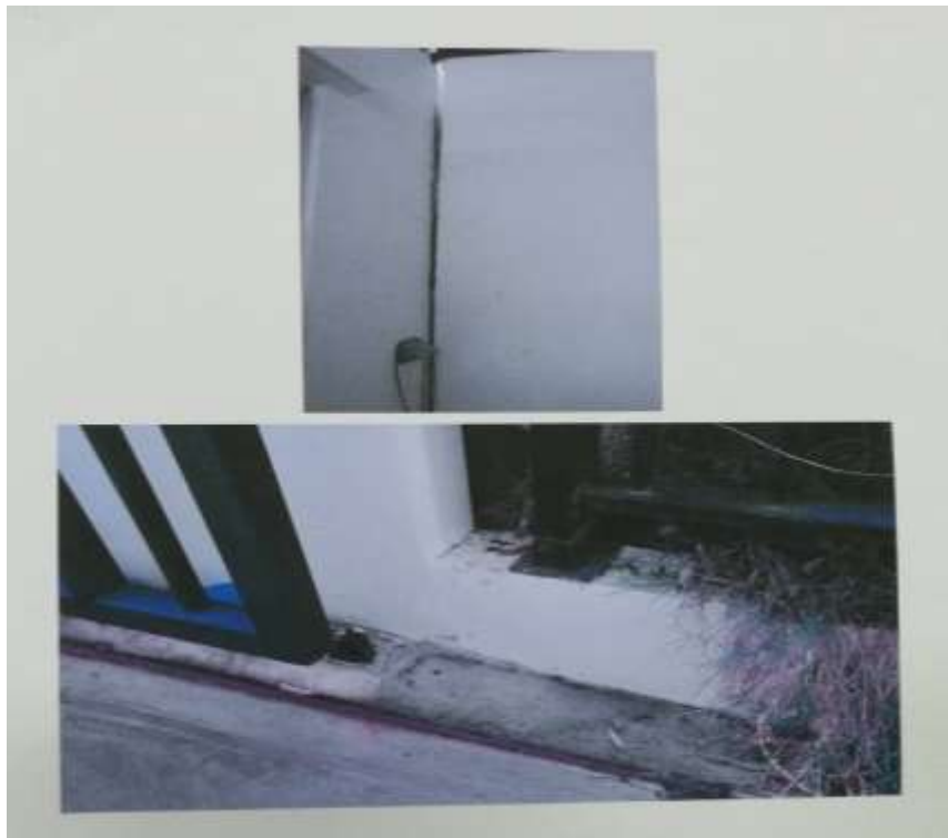
ภาพประกอบที่ 2.4 พื้นบ้านทรุดตัวทำให้เกิดรอยแตกแยกบริเวณท่อน้ำประปาและผนังบ้าน
