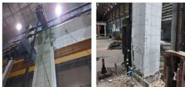
ข) การแตกร้าวที่ข้อต่อเสา-คาน ค) การแตกร้าวที่โคนเสา รูปที่ 6 การวิบัติของโครงข้อแข็งเสริมกำลัง BFS
