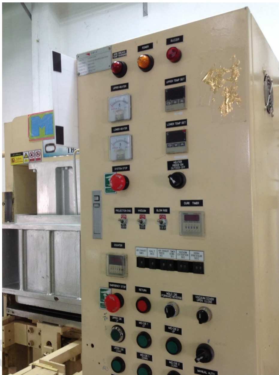
รูปที่ ก.3 ภาพถ่ายด้านหน้าตู้ควบคุม
